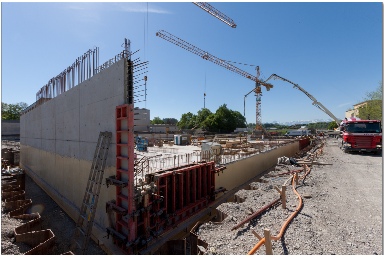
Die ersten grösseren Aussen- und Stützwände vermitteln einen Eindruck von den Dimensionen der Halle.
