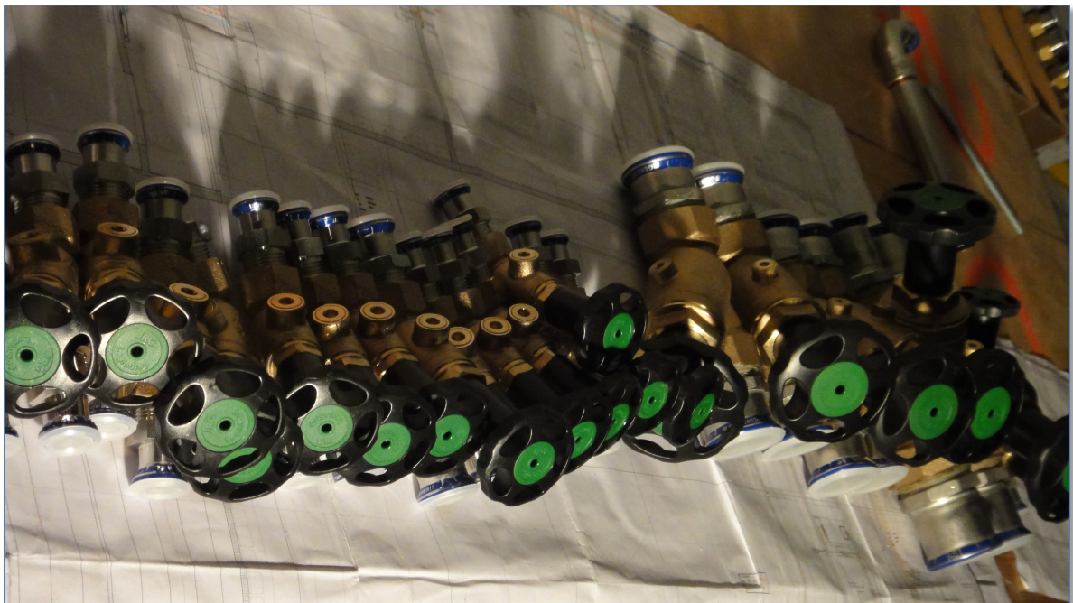
Und man beachte das perfekte "Mis en place" der für die Montage benötigten Ventile und Verbindungsstücke auf dem Arbeitstisch des Sanitärs. Auch das ist Teil der Präzisionsarbeit.
