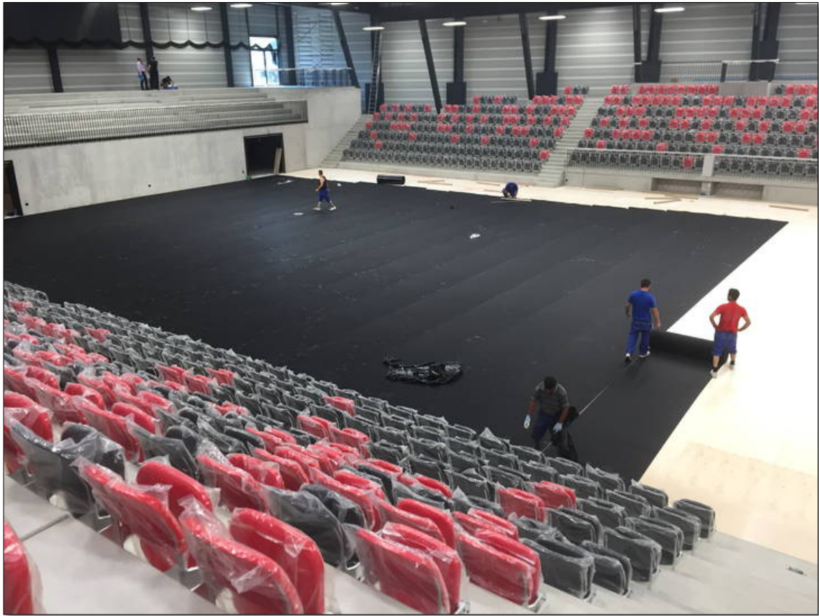
In einem nächsten Schritt wurde ein schwarzer gummi-kork-ähnlicher Bodenbelag in Rollen ausgelegt und auf die Holzplatten geklebt. Er dient als letzte Unterlage vor dem Aufgiessen des Kunststoff-Deckbelages des Sportbodens
