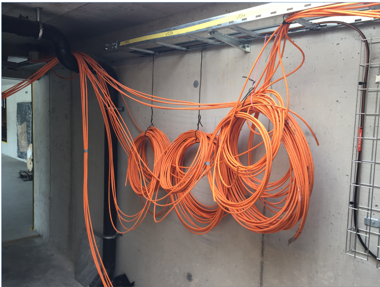
Kabel für das komfortable Netzwerk für Handyempfang und Free Public WLAN ...
